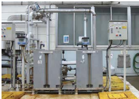
作業場付近の排水処理設備
