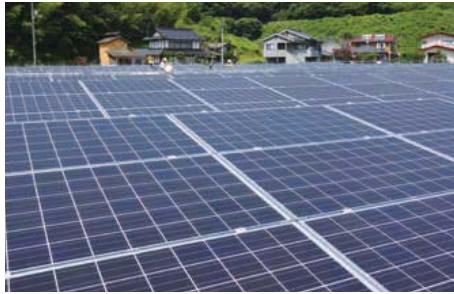
吉名メガソーラー発電所
