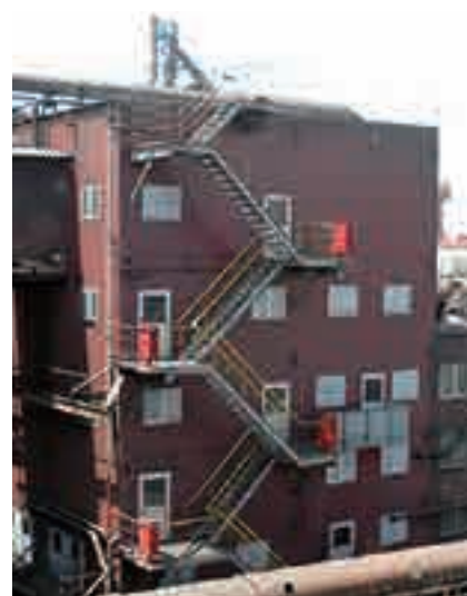
防災アクセスのための外階段と消火栓
