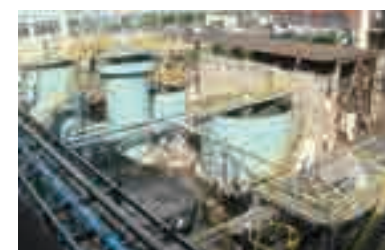
貯炭場排水浄化設備
