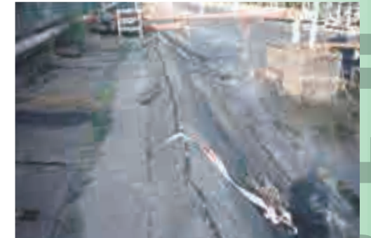
沈降ピット全面にクラックが入り水漏れ発生
