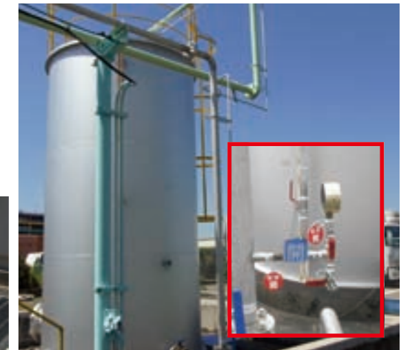
化学物質タンクの配管設置による圧抜き (赤線枠内: 圧抜き配管)
