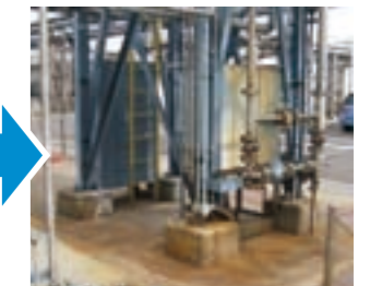
工業用水配管類 改善後
