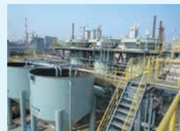
加古川工場活性炭排水処理設備
