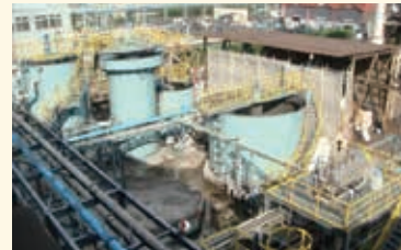
貯炭場排水処理設備
